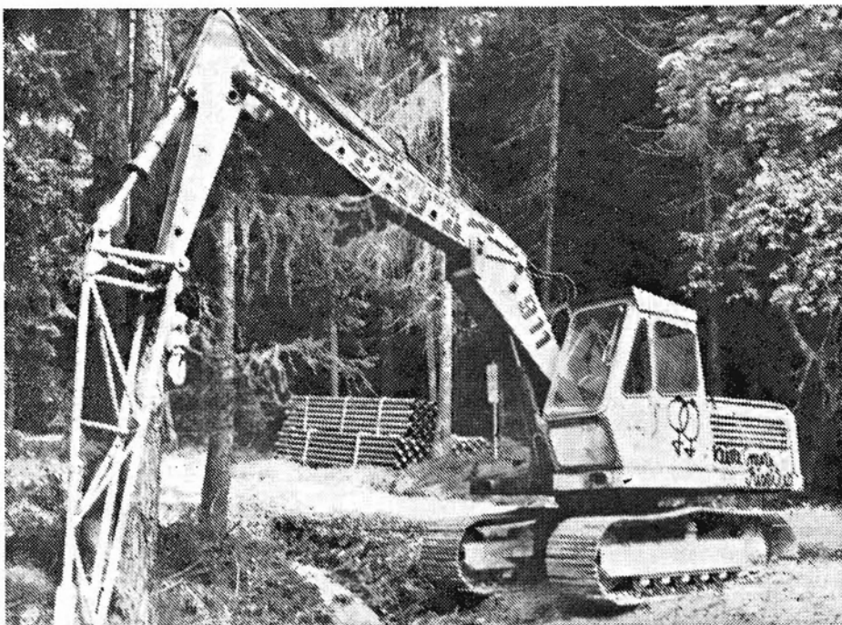
Ihrer Zerstörungswut freien Lauf ließen wieder einmal Unbekannte. Diesmal war der Bagger einer Baufirma, die im Staatsforst Faas eine Bohrung niederbringt und Rohre verlegt im Auftrag der Rheinhöhen-Wasserversorgung, das Objekt. Der Bagger wurde mit Parolen gegen die Stationierung von „cruise missiles“ beschmiert. Außerdem rissen die Unbekannten Kabel aus dem Motor und zerstörten die Hydraulik. Foto: Dupuis
